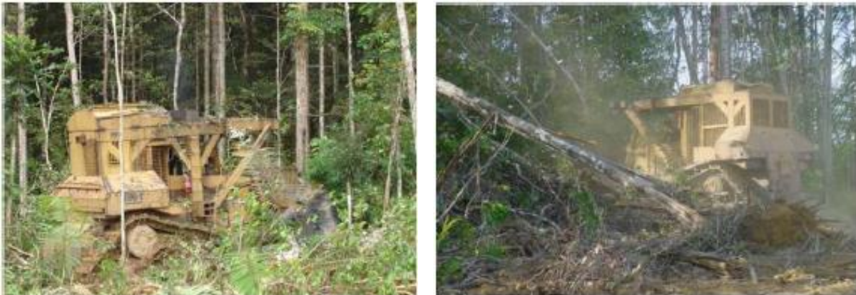
Figura 5.3-10. Registro da operação de desmate com emprego de trator de esteiras do tipo CAT. D11.
