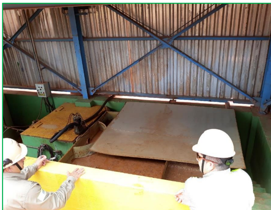
Figura 5 – Caixa S.A.O. já existente em área produtiva atual da MRN
