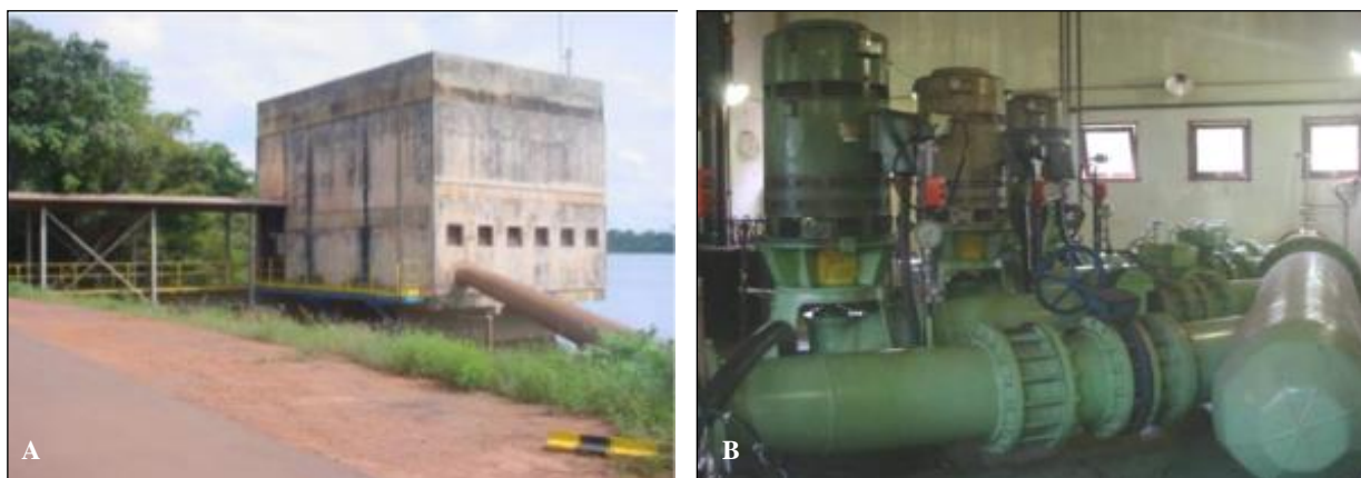
Figura 39 – Captação de água do rio Trombetas. A Foto A mostra o prédio que abriga as instalações e a Foto B mostra os conjunto motobombas.
