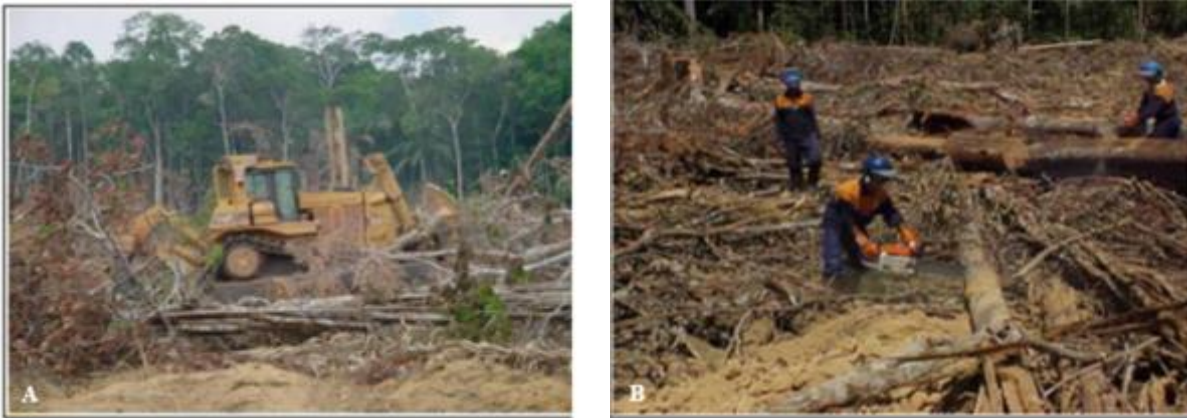
Figura 5.3-14. A) Registro das atividades de espalhamento da galhada; B) picagem da galhada com o emprego de motosserra.
