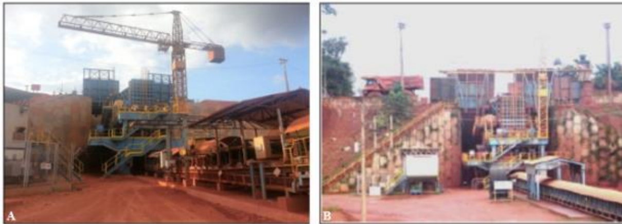
Figura 5.3-19. Instalação de britagem na MRN. A) Britador montado em um desnível do terreno; B) destaque para a descarga de minério na moega.
