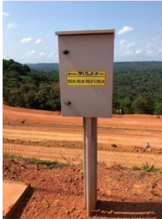
Figura 5.3-27. Estrutura de proteção e controle de acesso ao piezômetro.
