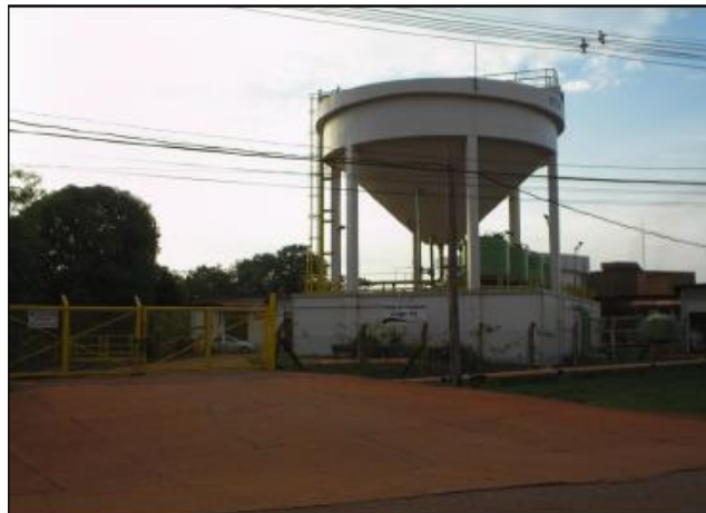
Figura 35 – Estação de Tratamento de Água na Vila de Porto Trombetas.
